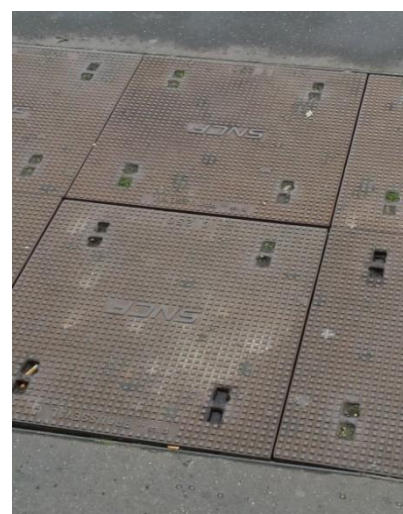
Installation électrique de gare
