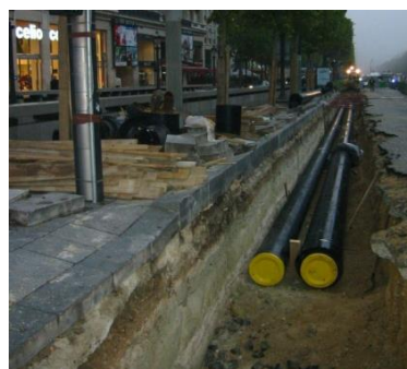
Réseau en pleine terre
