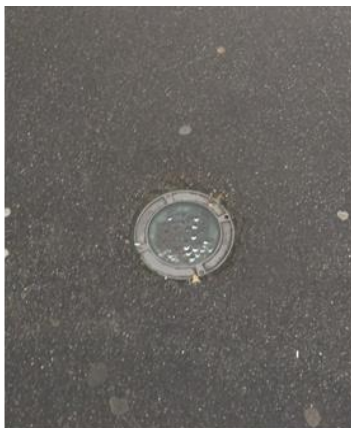
Éclairage par le sol
