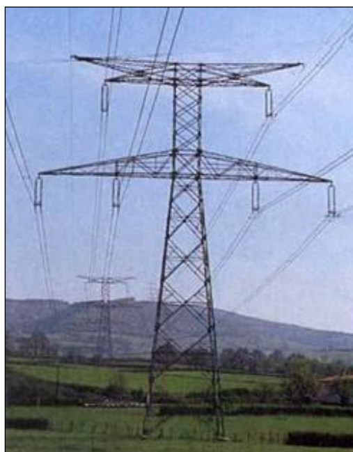
Réseau aérien HTB de 400 kV
