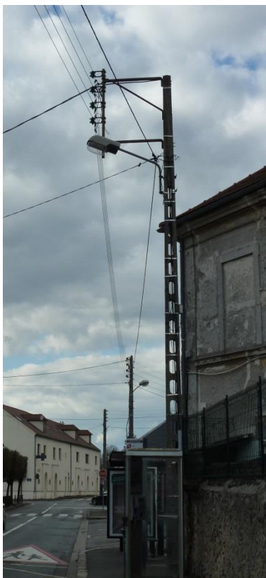
Éclairage public BT sur support béton commun
