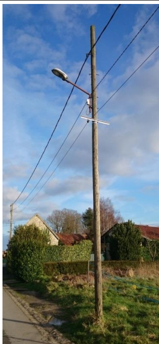
Éclairage public sur support bois commun
