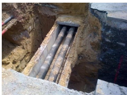
Réseau en caniveau
