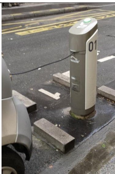
Borne de recharge électrique
