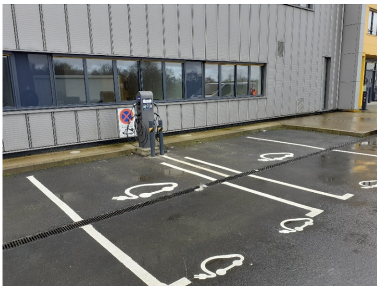
Exemple de station de recharge avec potelets de protection – SCE 2021
